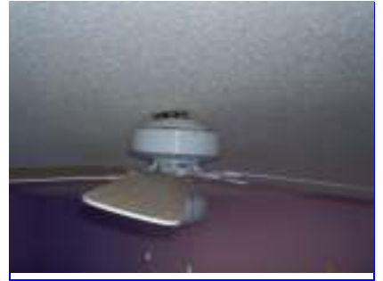
Ceiling fan loose
